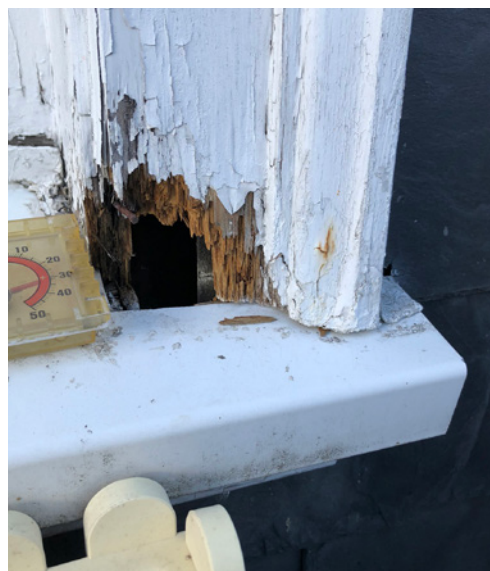
Beispiel 2: Holzfäule im Bereich eines Holzfenster- rahmens
