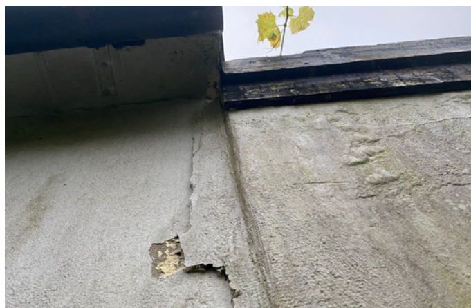
Beispiel 1: Risse im Putz an der Hauswand - Feuchteintrag
